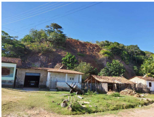
Figura 2: Moradias junto à base de encosta subverticalizada. Setor 001. Pontal de Coruripe.
