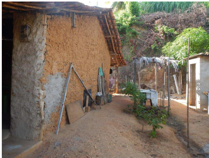
Figura 4: Moradia em taipa próximo à encosta. Setor 009. Bairro de Barreiras, Rua das Flores.
